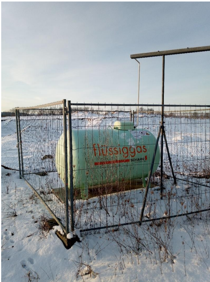
Abb.13 Foto Flüssiggastank. © BVV. Quelle: Beispielfoto Angebot von Firma Scharh, bearbeitet.
